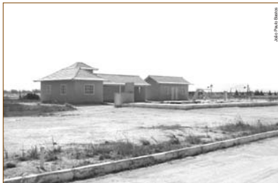
Índice da construção de um condomínio sobre uma salina abandonada. A obra foi embargada
