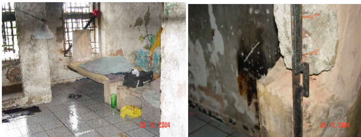
(foto 01: outra cela toda inundada; foto 02: porta da cela destruída)
