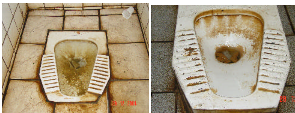
(foto 01: sanitário entupido com água; foto 02: sanitário entupido com fezes)
