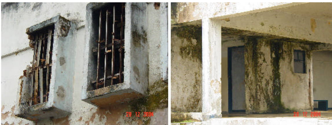
(foto 01: parede externa das celas soltando grandes pedaços; foto 02: paredes podres no hospital)
