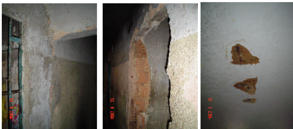
(foto 01: parede de uma cela que foi derrubada por uma interna; foto 02: porta da cela destruída; foto 03: uma galeria onde caem pedaços inteiros do teto)
